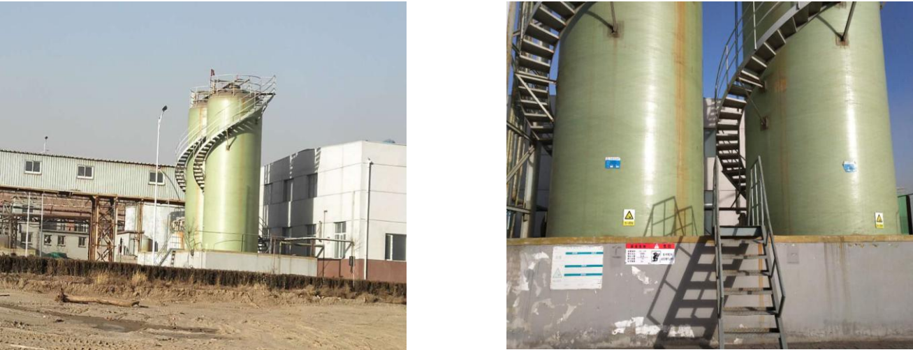
图 4-13 盐酸储罐及废气回收装置
