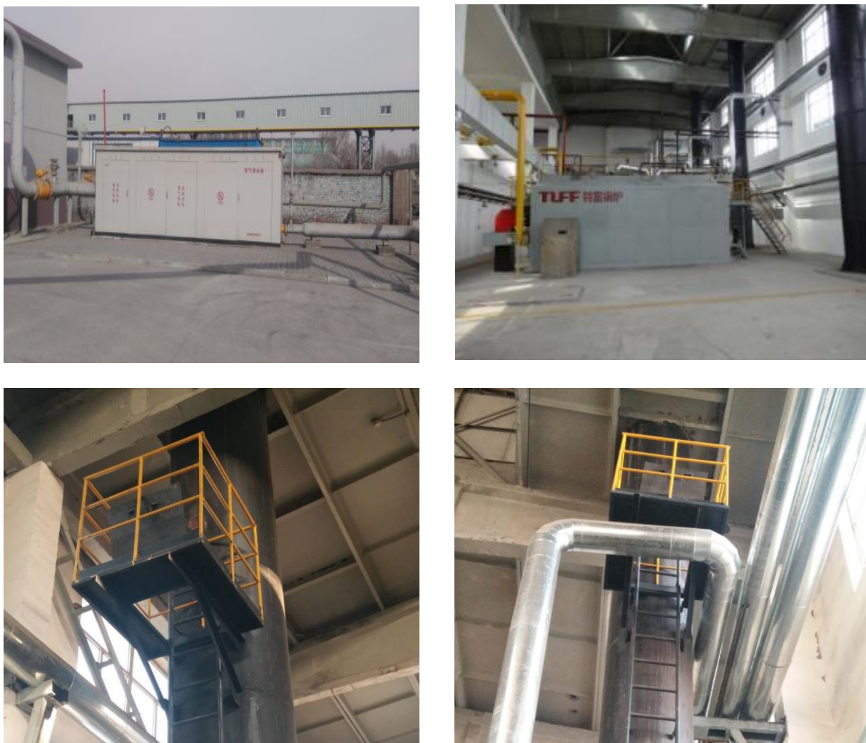
图 4-10 燃气调压站、燃气锅炉及监测平台
