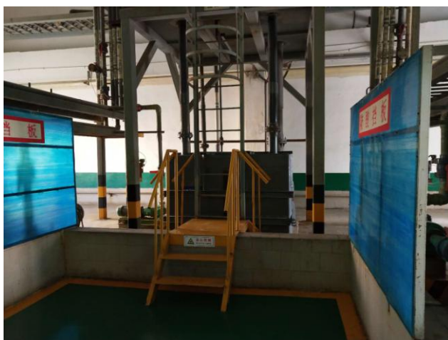
图 4-24 盐酸储罐废气回收装置
