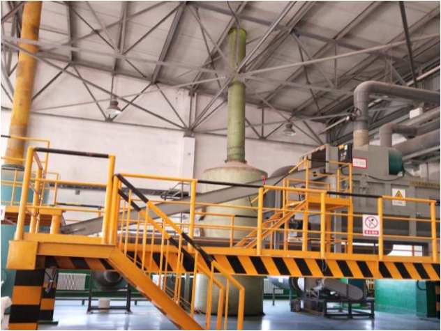
图 4-28 氨气吸收装置及排气筒
