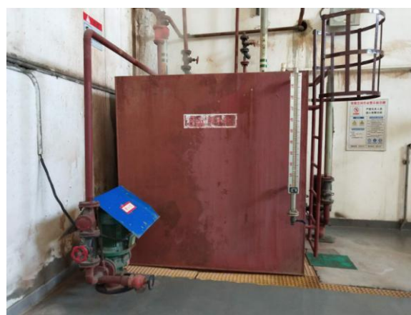
图 4-13 锅炉房—废水箱
