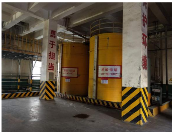
图 4-5 酸回收原酸储罐
