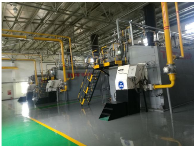
图 4-21 燃气锅炉房内锅炉
